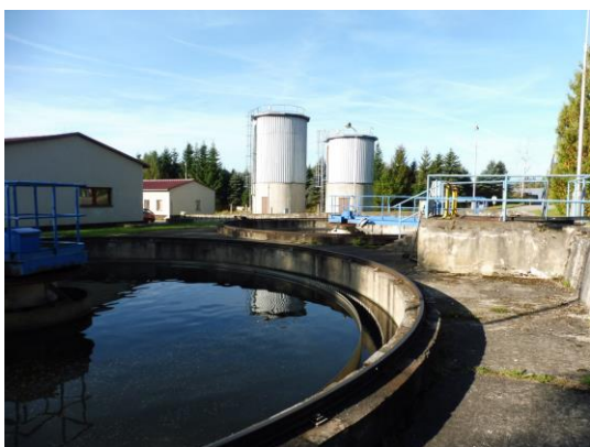
Kalové hospodářství – kalové nádrže
