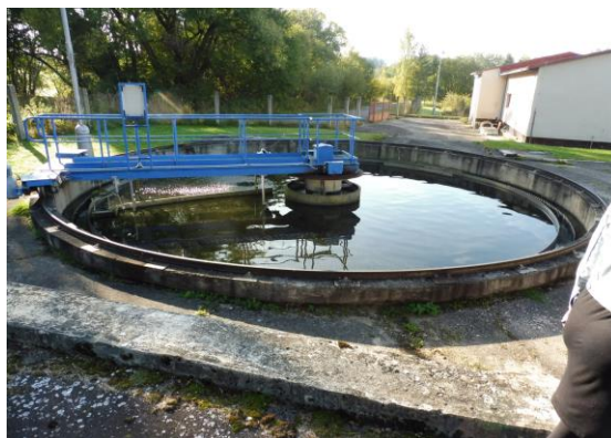
Biologické čištění – dosazovací nádrže
